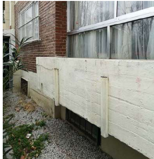
Fig. 11. Detalle de la terraza de las torres, estado actual. Jardinera original, pero reforzada. Fotografía del autor, 19 de marzo de 2022
