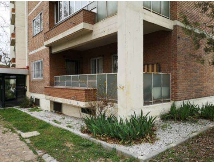
Fig. 10. Detalle de la terraza de las torres, estado actual. Nótese la sustitución del hormigón de la jardinera por ladrillo. Fotografía del autor, 19 de marzo de 2022
