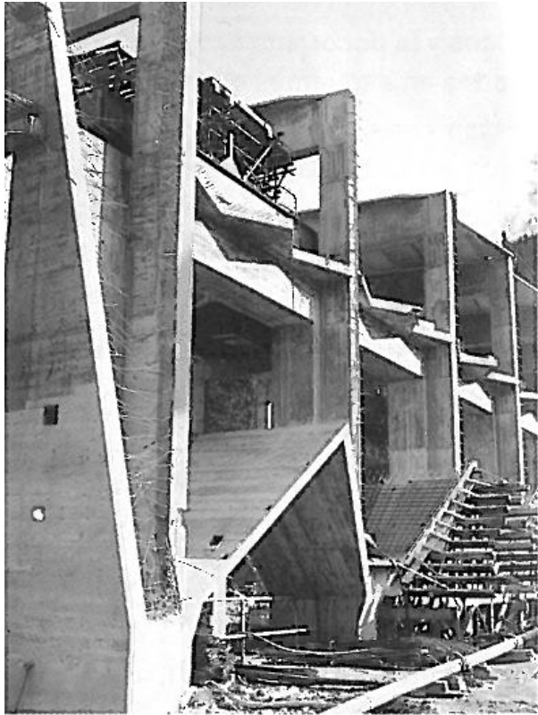
Fig.6. Estructura de fachada de Proaza. Fotografía recogida en Vaquero Palacios, Medalla de Oro de la Arquitectura 1996, Consejo Superior de los Colegios de Arquitectos de España, Edición a cargo de Atxu Amann y Andrés Cánovas, p.136.
