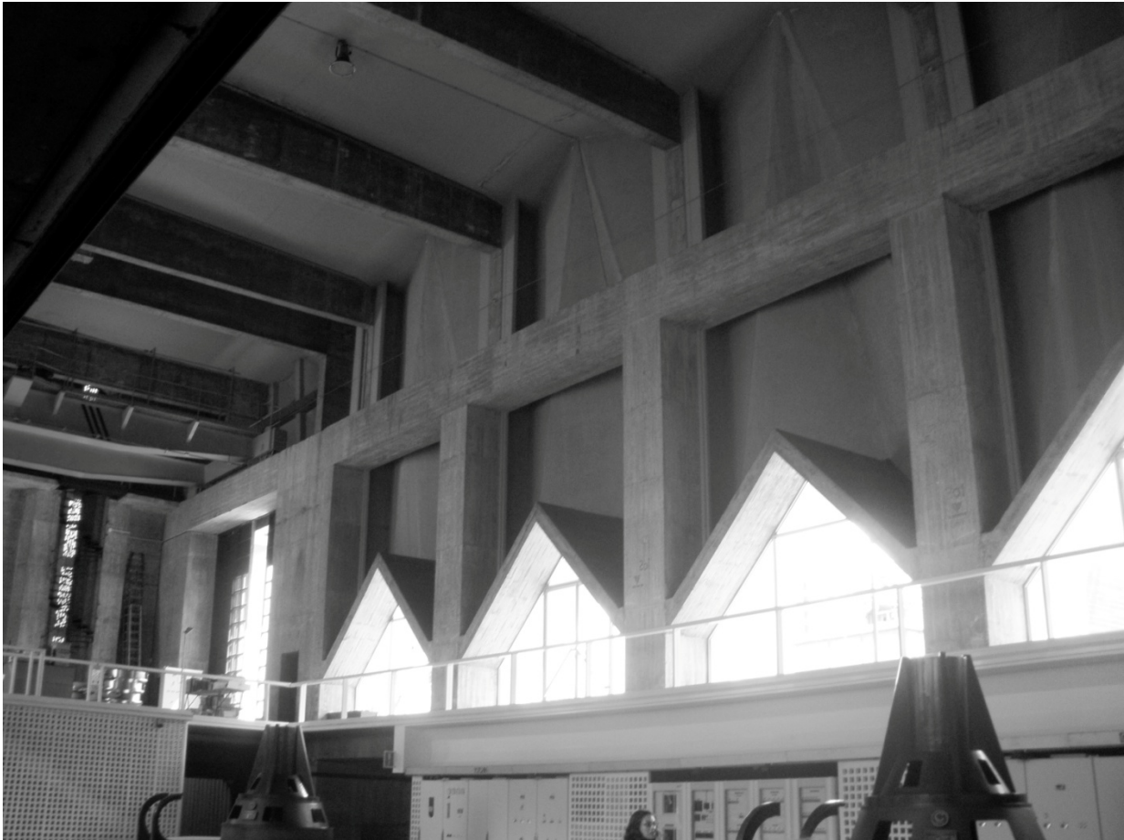
Fig.5. Interior de Central de Proaza. Fotografía de autores de comunicación.
